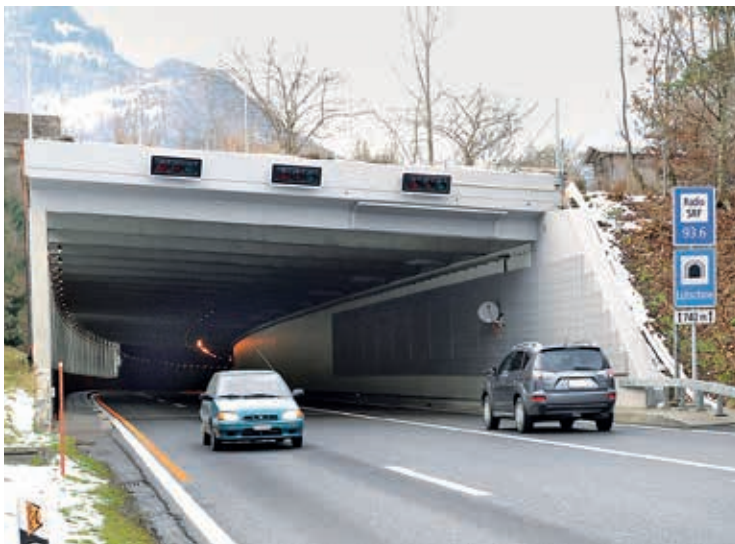
In der Lüttschinenunterführung wird nun die südliche Hälfte (links im Bild) saniert.
