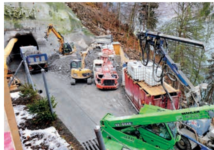
Die engen Platzverhältnisse beim Ostportal des Giessbachtunnels stellen die Bauarbeiter vor grosse Herausforderungen.
